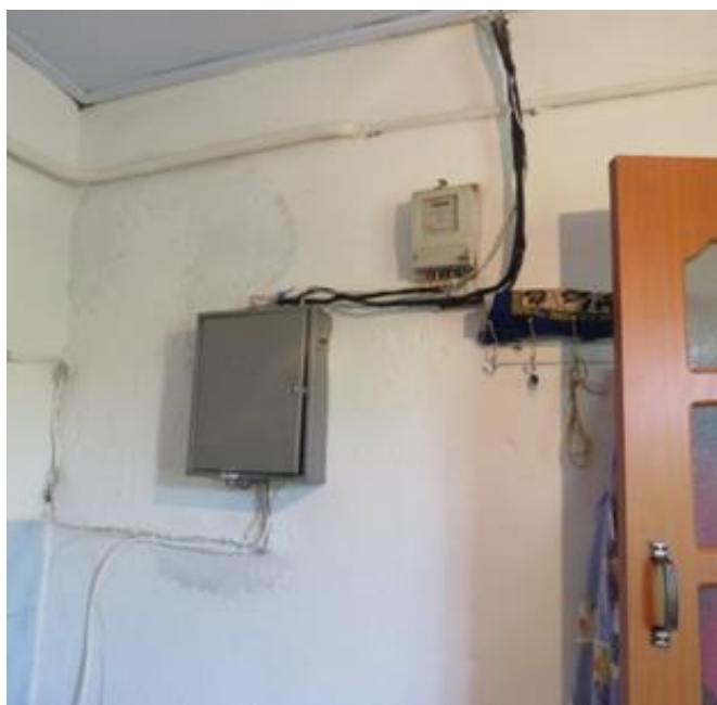
Токтогульское ССУ. Незакрытые электропровода
