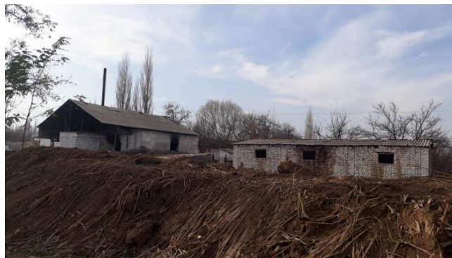
2 Зброшенныя пасля пожара зданія, размешчаныя недалёка ад морга на тэрыторыі Кадамжайскага ССУ
