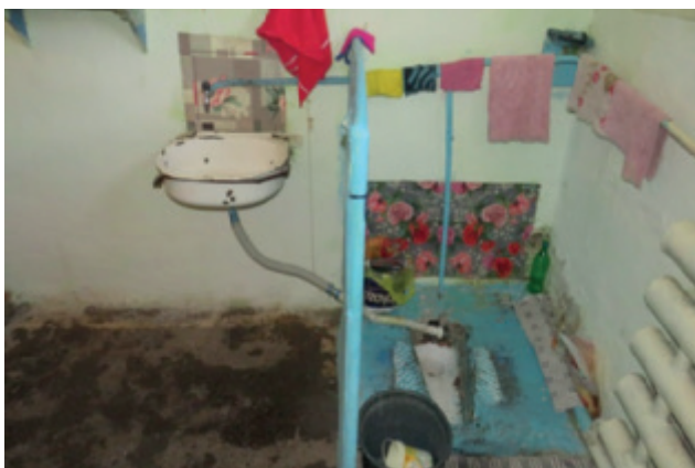
Фото. Состояние умывальной раковины, отсутствие воды для слива в туалете женской камеры СИЗО при ВК-14
