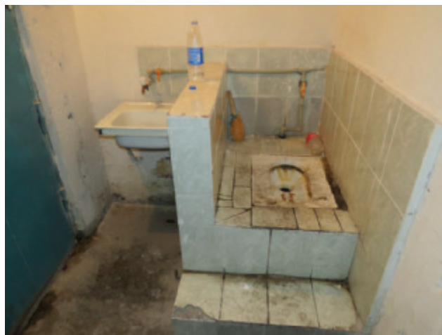
Фото. Санузел для камер ШИЗО в СИЗО-3
