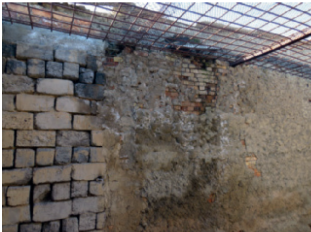
Фото. Разлагающаяся стена в прогулочном дворе
