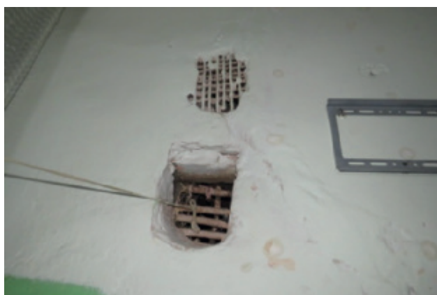
Фото. Состояние вытяжки в женской камере СИЗО-3
