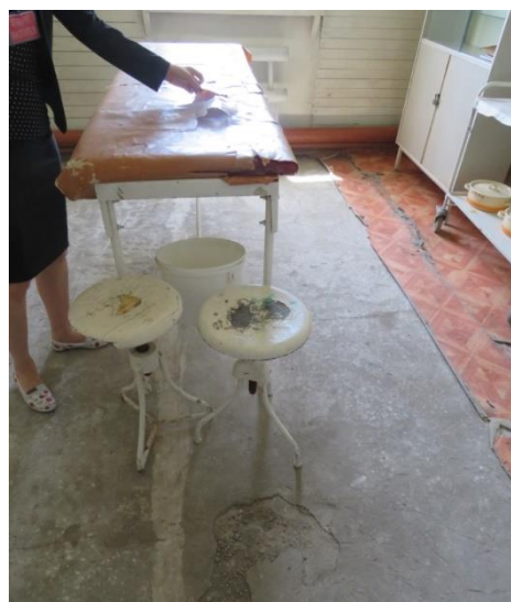
Фото 76. Процедурный кабинет войсковой части в г.Ош
