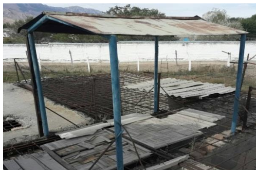
Фото 43. Прогулочный двор СИЗО-4 до ремонта. 2017 год.
