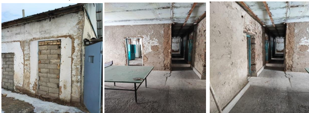
Фото 44, 45, 46. Состояние зданий и помещений колонии-поселения №39
