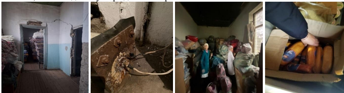
Фото 64, 65 Помещение в аварийном состоянии, оголенные провода
