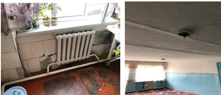
Фото №253. Требуется капитальный ремонт в помещениях
