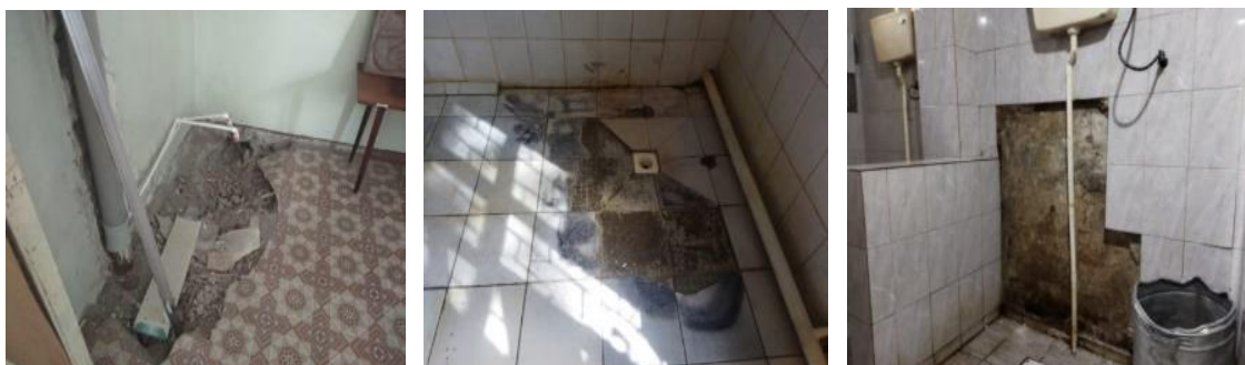
Фото №229,230,231. Аварийные условия в помещениях, душевой и туалете
